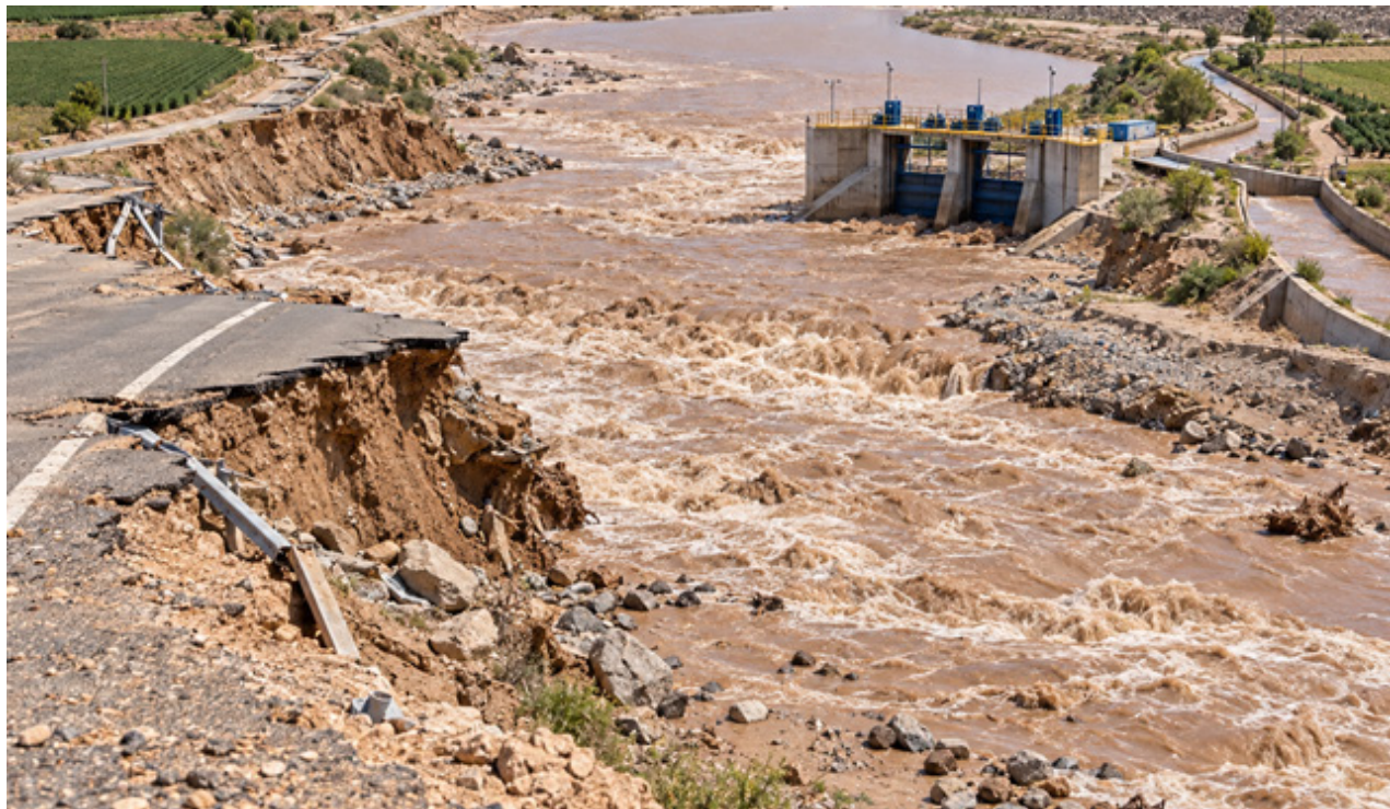
Figura 17. Escenario ilustrativo de potencial daño en represas y sistemas hidráulicos: erosión de accesos, afectación de canales y vulnerabilidad de obras auxiliares.
